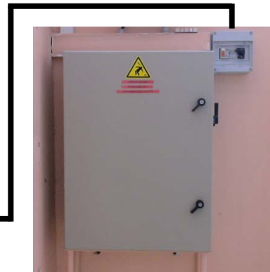
Armoire de distribution
